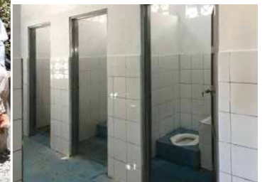
村に水が引かれたことで、小学校に水洗トイレと手洗い場が整備されました
