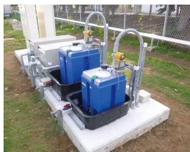
▲有機炭素源(メタノール)とアルカリ源(水酸化ナトリウム)の添加設備
