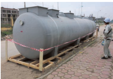
イエンサー幼稚園に設置されたPCNⅢ型浄化槽
